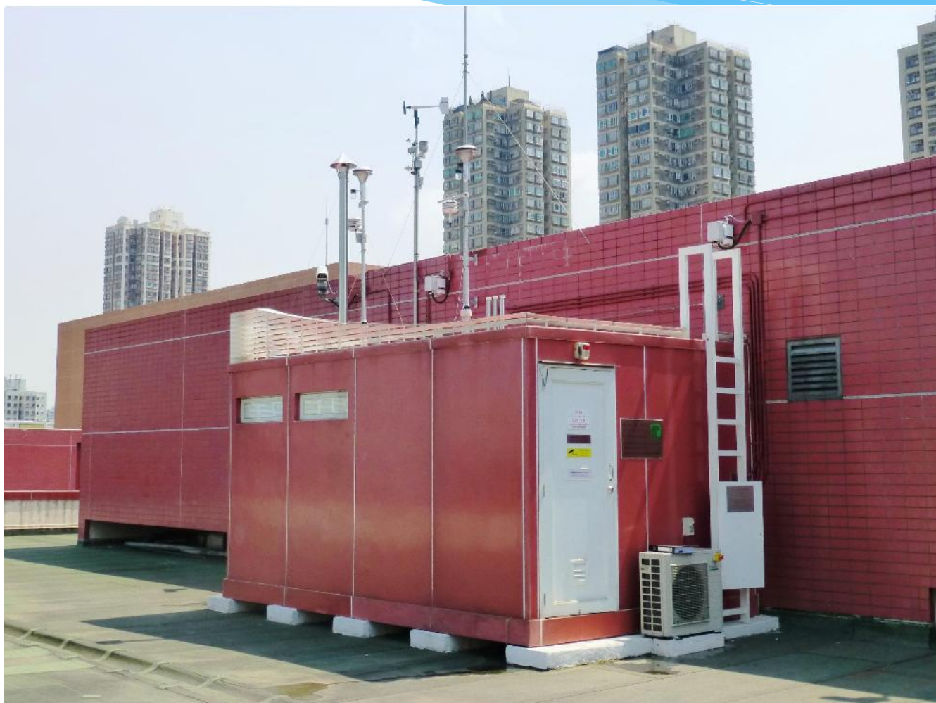
屯門空氣質素監測站
