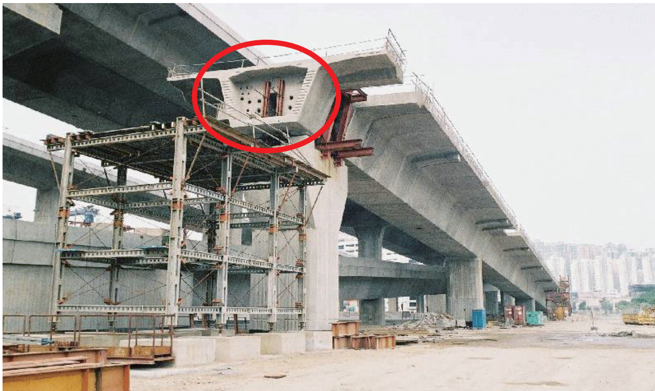
▲ 吊樑機把橋樑塊件（如紅圈所示）吊裝在兩座橋墩之間，再用預應力鋼筋串起塊件連橋墩一併固定。
