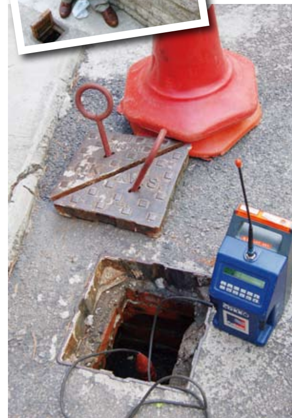
▲ 藉着漏水所產生的聲波傳播到不同傳感器的時間差異，「漏水噪聲相關儀」可快速計算出水管漏水點的位置。
